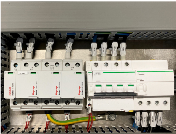
Abbildung 5+6: Potentialausgleich über die geerdete Rückwand einer Schaltanlage
