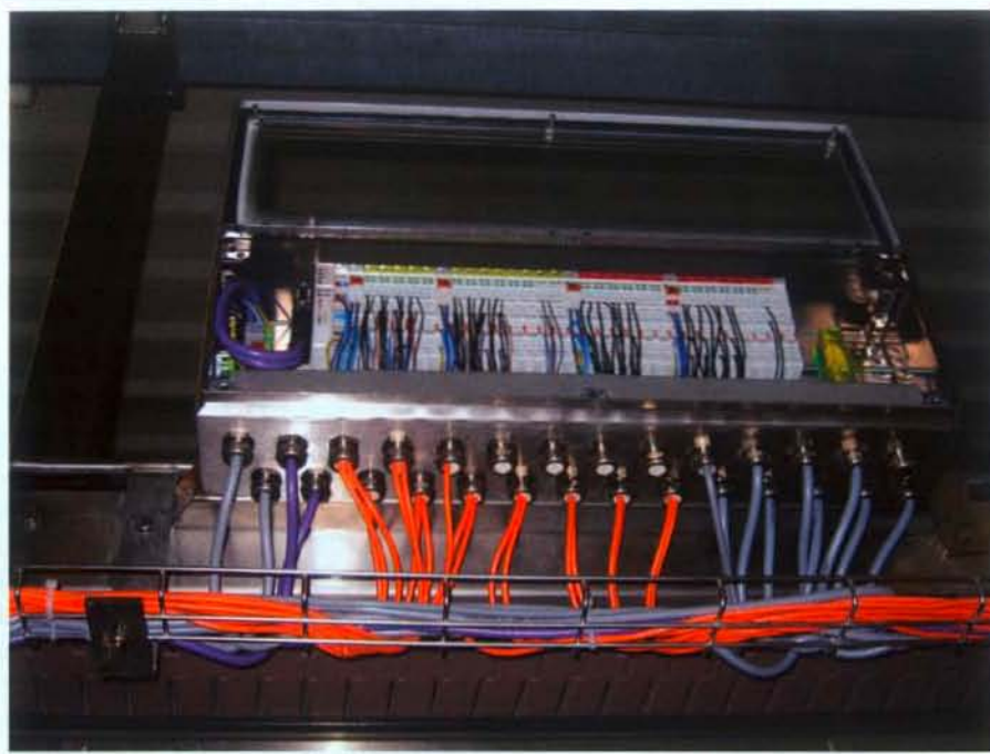
Bild 3: Zu den einzelnen Elektro- und Steuergehäusen in der MUH-Fertigung werden die Kabel über offene Gitterkanäle geführt. Die zuverlässige Kabeleinführung ins Gehäuse läuft über verschiedene UNI Dicht-Kabelverschraubungen (Foto: MUH)
